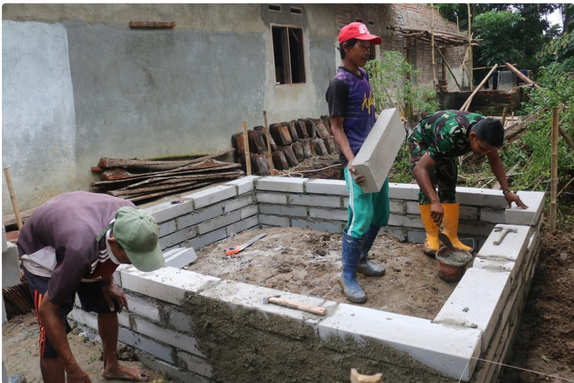
Serang – Satuan Tugas (Satgas) TNI Manunggal Membangun Desa (TMMD) Ke-119 Kodim 0602/Serang hari ke-20 bersama warga bekerja bersama membangun pos kamling di lokasi TMMD Kampung Cislak, Desa Bojong Pandan, Kecamatan Tunjung Teja, Kabupaten Serang, Provinsi Banten, Minggu (10/03/2024).
